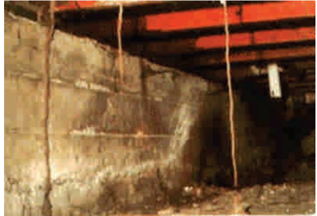
Figura 2 - 11: Túneles elaborados por termitas subterráneas desde el terreno, el cual contiene una humedad permanente por no estar ventilado en la zona bajo la plataforma.
