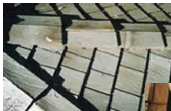
Cubierta de madera sin mantención
