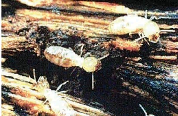
Figura 2 - 10: En la imagen se observan termitas subterráneas en pleno ataque a una solera de un tabique.
