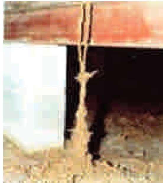
Figura 2 - 12: Túneles generados por las termitas subterráneas desde el terreno al friso, formando túneles con barro protector llamados tubo refugio. Conformados por fragmentos de tierra y madera digerida cementada con excrementos de las termitas obreras.
