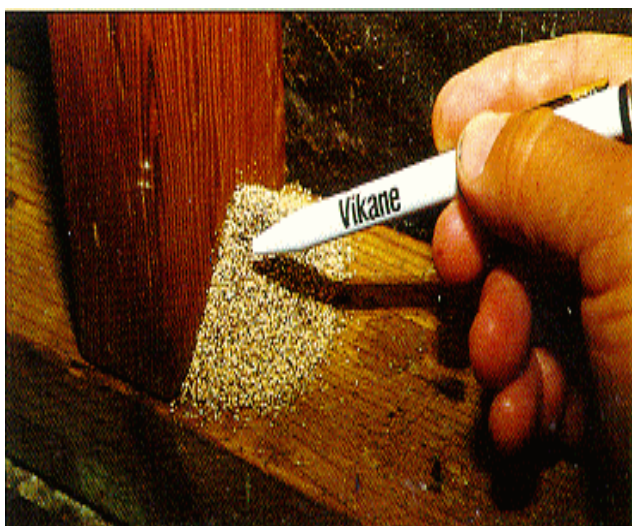
Restos de termitas de madera seca
