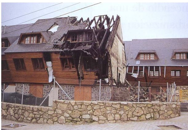
Construcción de madera severamente afectada por un incendio
