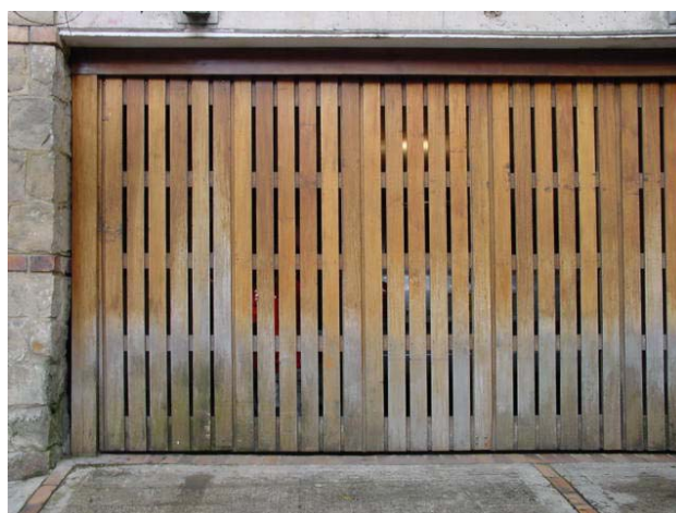
Degradación de la madera por efecto de la intemperie
